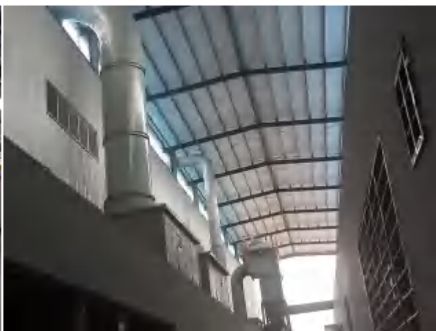
浇筑的除尘器及排气筒
