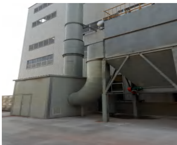
混砂机的除尘器及排气筒
