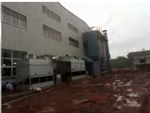
熔炉的除尘器及排气筒
